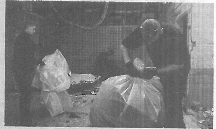
Die Mitarbeiter vom Rendsburger Abbruchunternehmen Elly Nickels räumen die letzten Schutt-Säcke weg.
